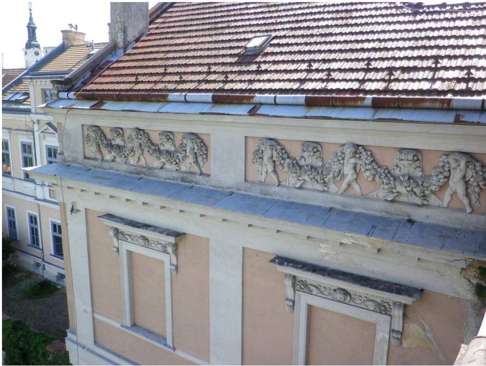
4.12. A D-i szárny K-i homlokzatának felső része
